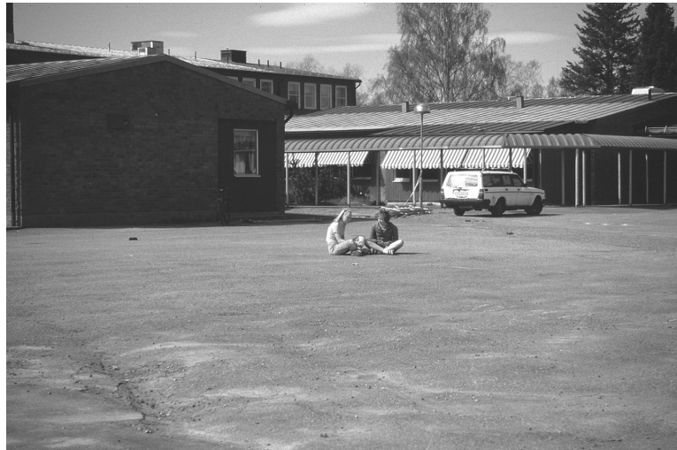
Foto 2. Den slitna asfalterade skolgården innan upprustning.
